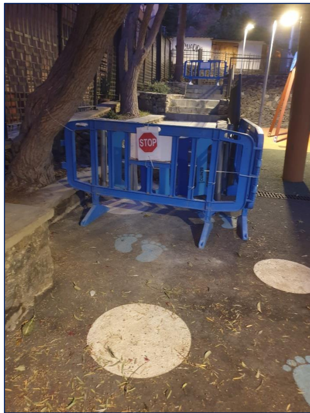
Realización de obras con personal propio por mala ejecución de las obras proyectadas.
