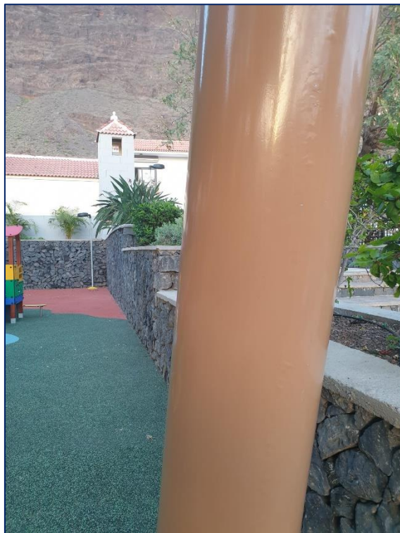
Ausencia de vallado de protección anticaídas.
